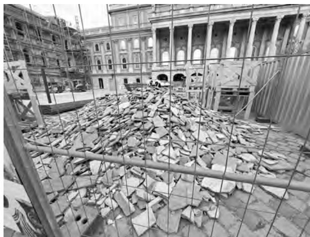
A Várpalota „A”-épülete központi csarnokában elpusztított, vörösmárvány díszburkolat törmelékhalma (a szerző archívuma, 2023. október 9.)
